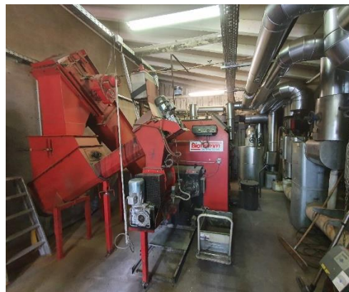
Ansicht 158: Hackschnitzelheizanlage in Schöffengrund (Aufnahme vom 8. Juni 2021)
