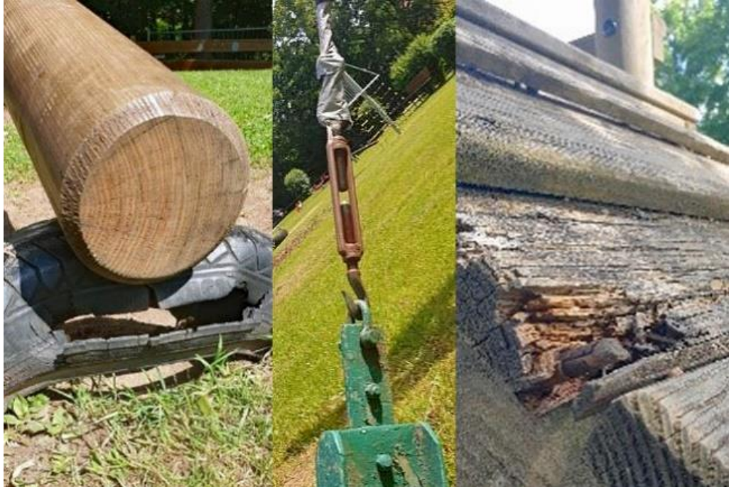
Ansicht 76: Beispiele für sicherheitsrelevante Mängel an Spielgeräten, v. l. n. r. defekter Puffer an einer Holzzippe, bodennahes einseitig offenes Spannschloss mit aufragender Spitze an einer Seilbahn, Holzverrottung am Aufstieg eines Kletterturms (Aufnahmen Mai bis Juni 2023)
