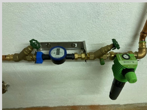
Ansicht 89: Funkwasserzähler in Bad Emstal (Aufnahme vom 25. Januar 2024)
