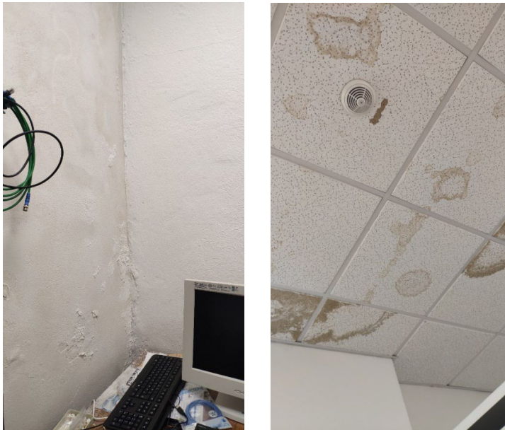
Abbildung 33-1: Feuchtigkeitsschäden im Raum für Bühnentechnik
